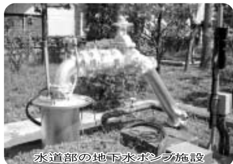
水道部の地下水ポンプ施設
