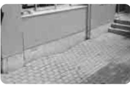
新築中学校内(地盤沈下)
