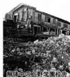
震害中の上野学園校舎
